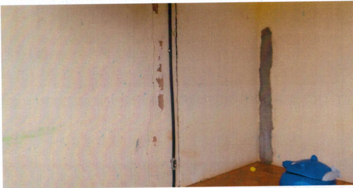
TRINCO NA PAREDE
