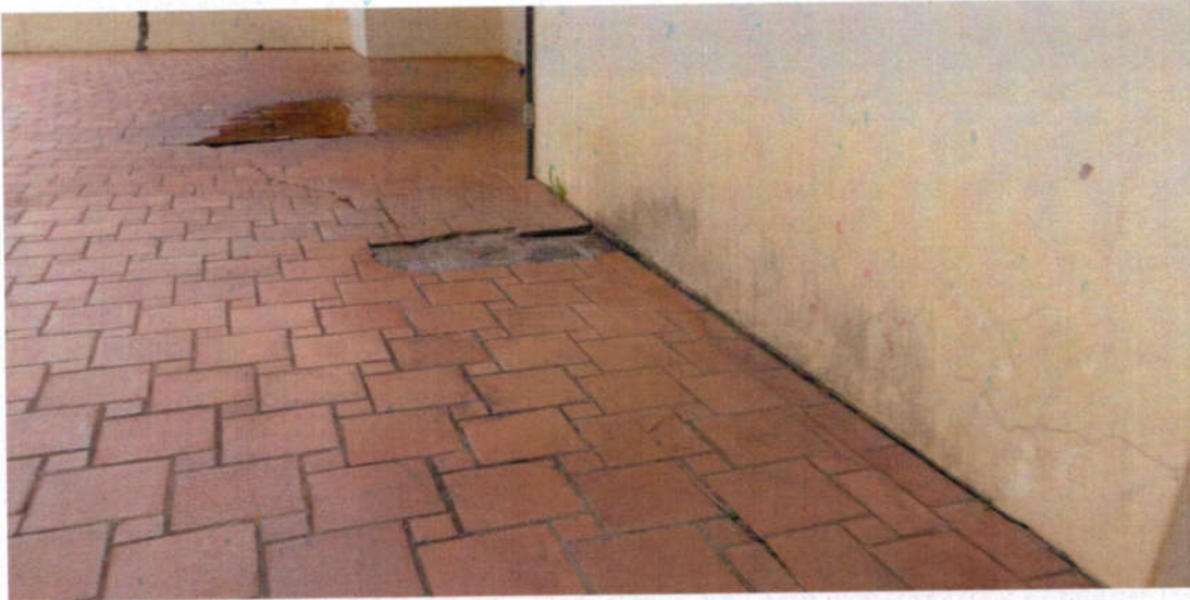
PISO COM DANOS – FENDA ENTRE PAREDE E PISO
