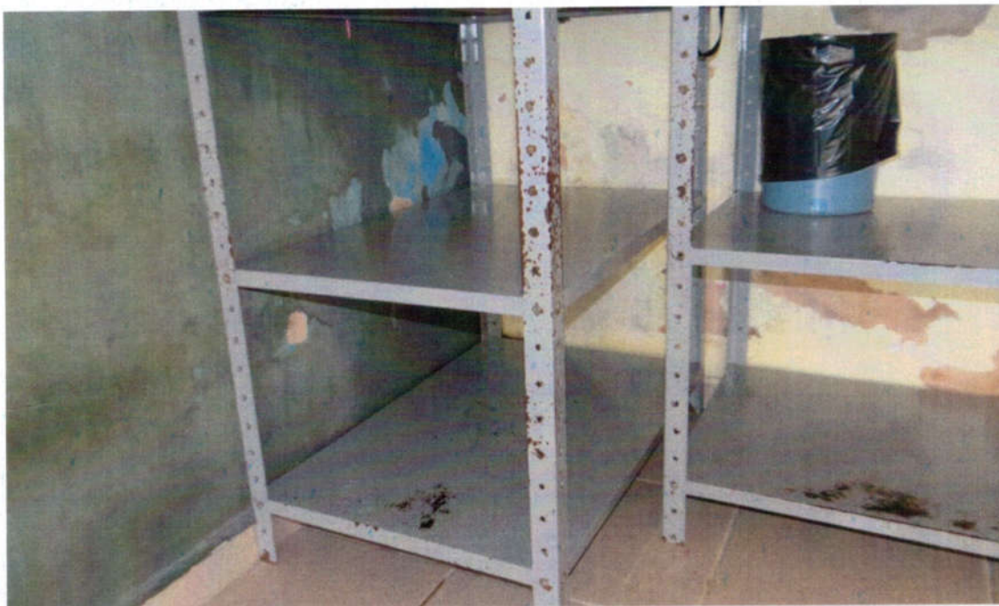
DANOS NA PINTURA - INFILTRAÇÃO
