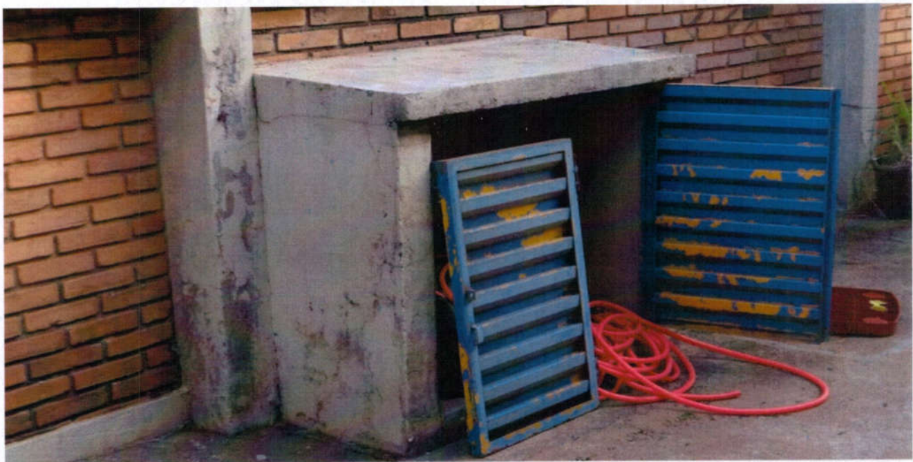
CASA DO GÁS PORTAS QUEBRADAS
